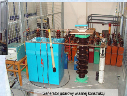
Generator udarowy własnej konstrukcji
