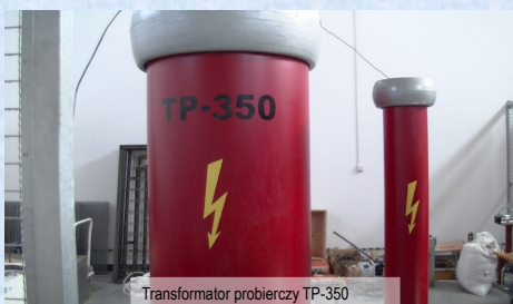
Transformator probierczy TP-350
